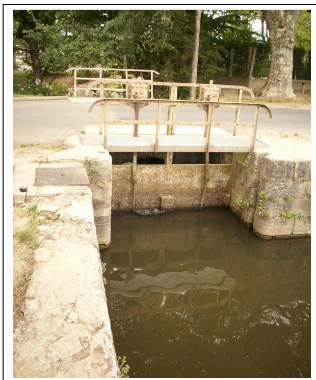
Vannes de régulation de la Rigole au droit du Moulin du Roi
