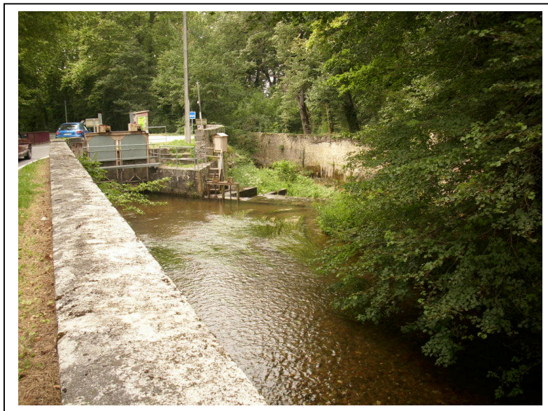
Vannes d'alimentation de la Rigole à Pont Crouzet
