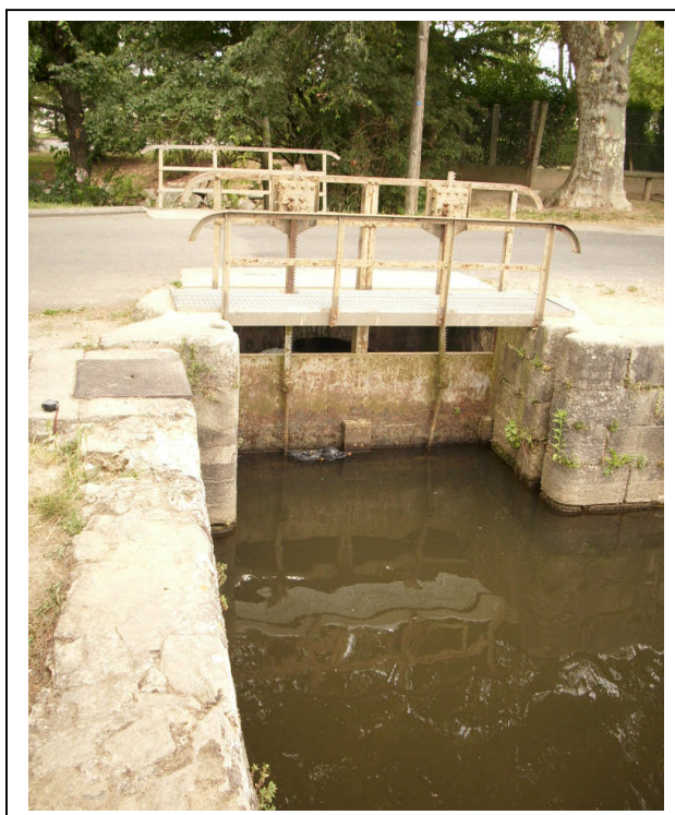
Vannes de régulation de la Rigole au droit du Moulin du Roi
