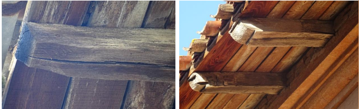
Mise en œuvre traditionnelle des débords de toit : abouts de chevrons en bec de flûte et en quart-de-rond
