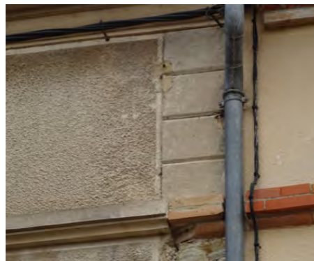
Décor d'enduit formant des bossages, ils ont été piqués en partie basse.
