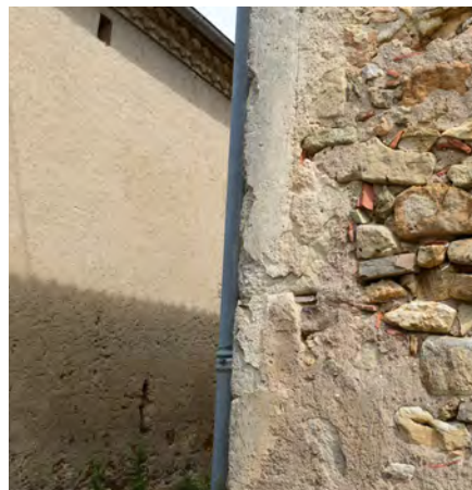
Chaîne d'angle harpé avec une variation dans l'enduit, il reste quelque trace de badigeon sur le harpage, le bandeau et la génoise (Revel).
