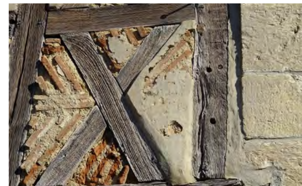
Maison à Touget dans le Gers, elle conserve un enduit venant masqué le remplissage de brique. Un chanfrein vient assurer la jonction entre les deux matériaux.
