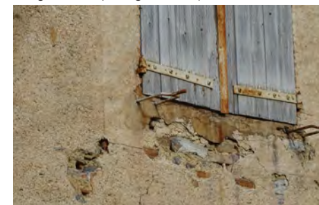
La brique est masquée par un enduit lissé dont l'encadrement est droit.
