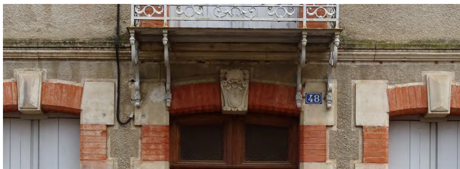
Badigeon ocre rouge sur les briques pour unifier la teinte des joints et de la brique.
