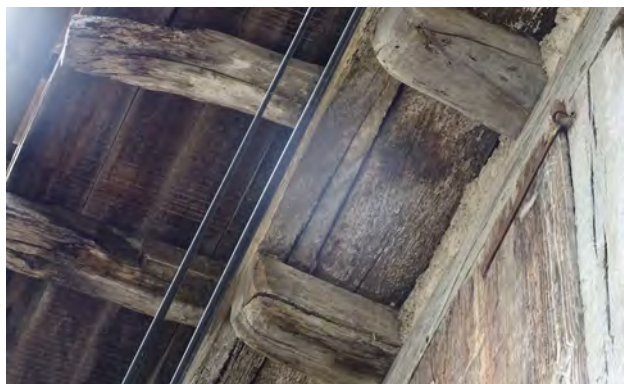
Débord avec sablière en encorbellement soutenue par des solives, les chevrons ont des abouts en bec de flûte (n°31, rue des Sœurs).
